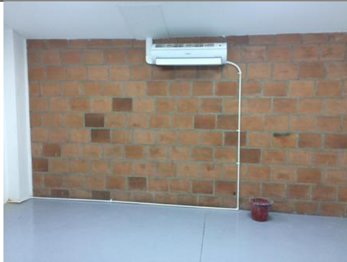
Suministro de aire acondicionado.
