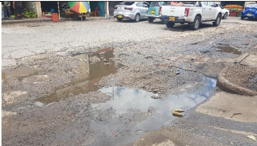
EMPOZAMIENTO DE AGUAS NEGRAS POR LAVADO DEL CHUTE
