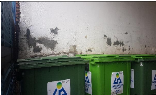
ESTADO DE PAREDES
