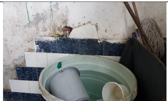
RESERVORIO DE AGUA PARA ACTIVIDADES DE LIMPIEZA
