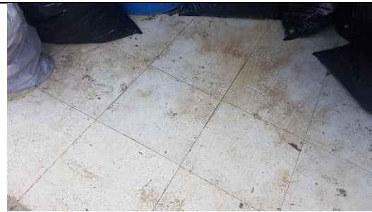
ESTADO DE PISOS
