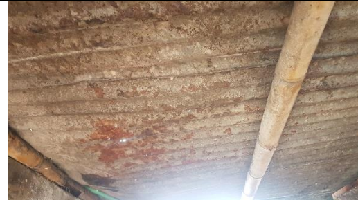
ESTADO DE TECHOS
