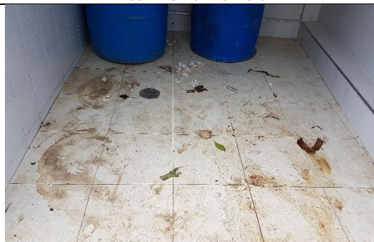
ESTADO DE PISOS
