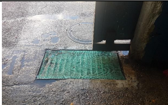
REJILLA DE RECOLECCIÓN DE AGUAS NEGRAS
