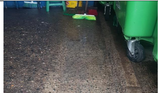
ESTADO DE PISOS
