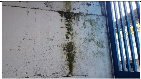
ESTADO DE LAS PAREDES
