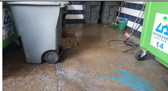
ESTADO DE LOS PISOS
