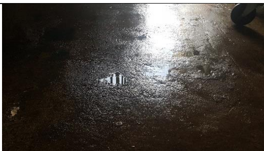
ESTADO DE PISOS
