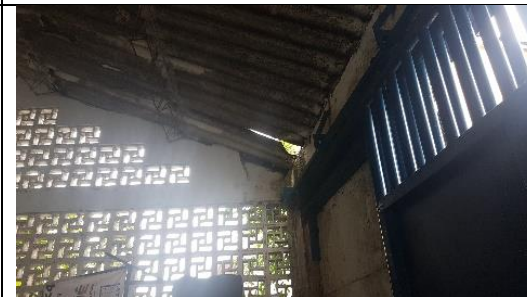
ESTADO DE TECHOS
