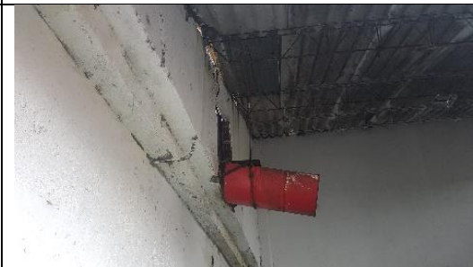
DUCTO DE EVACUACIÓN DE RESIDUOS
